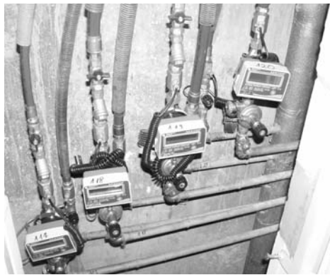
Рис. 9.12. Размещение квартирных тепломеров на лестничной площадке
